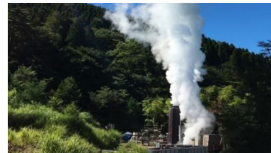
熊本県阿蘇郡南阿蘇村の地熱発電施設
