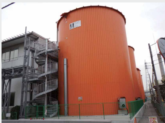
バイオガス発電設備
